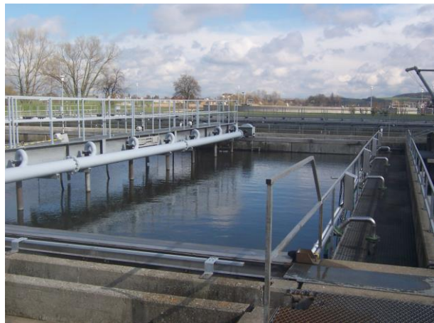
Endreinigung im Nachklärbecken
